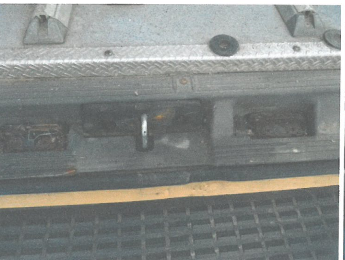
KOROZJA PASA TYLNEGO
