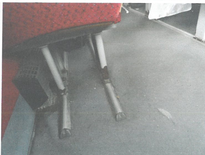
KOROZJA MOCOWAŃ FOTELI
